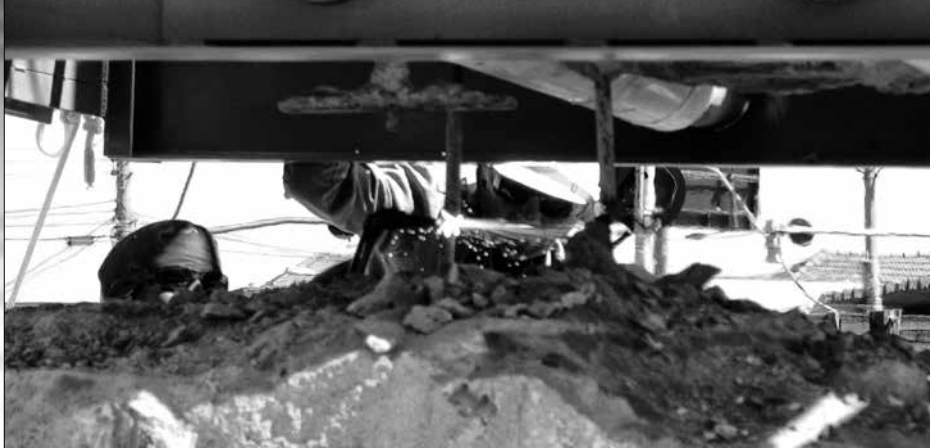
Imagem do momento em que a última barra de aço que ligava o Laçador ao pedestal original é cortada.
